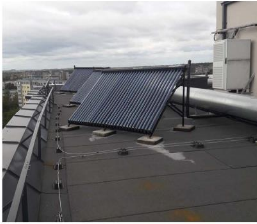
Šilumos siurblio elektros sąnaudų kompensavimui sumontuoti saulės kolektoriai.
