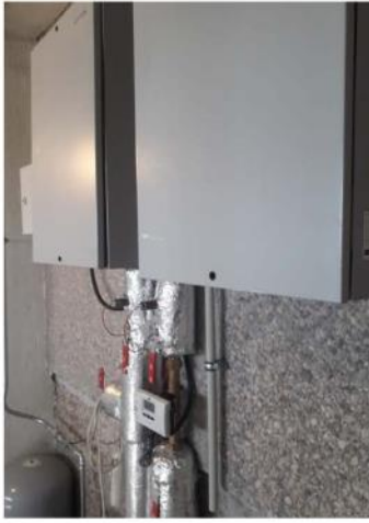
Saulės kolektorių ir šilumos siurblio vidinė dalis ir energijos apskaita.
